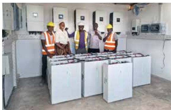
Mali. Impianto fotovoltaico Villaggio "Don Mario Pasini" di Ségou
